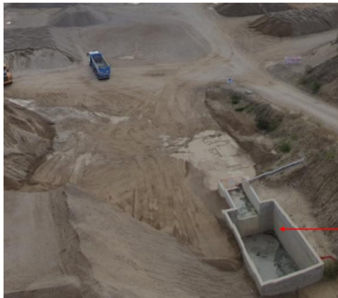
Bassin récupérant l'eau de ruissellement pour ensuite la traiter
